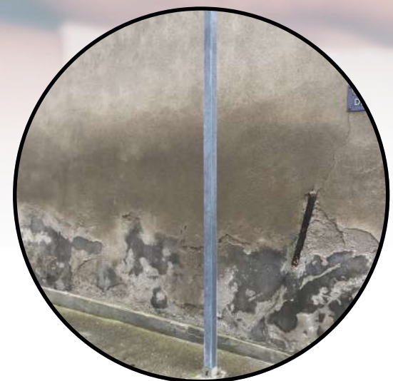
Linea di umidità
