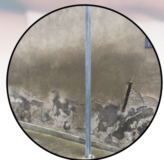
Línea de humedad
