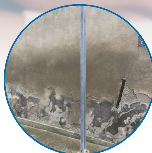
Linha de umidade
